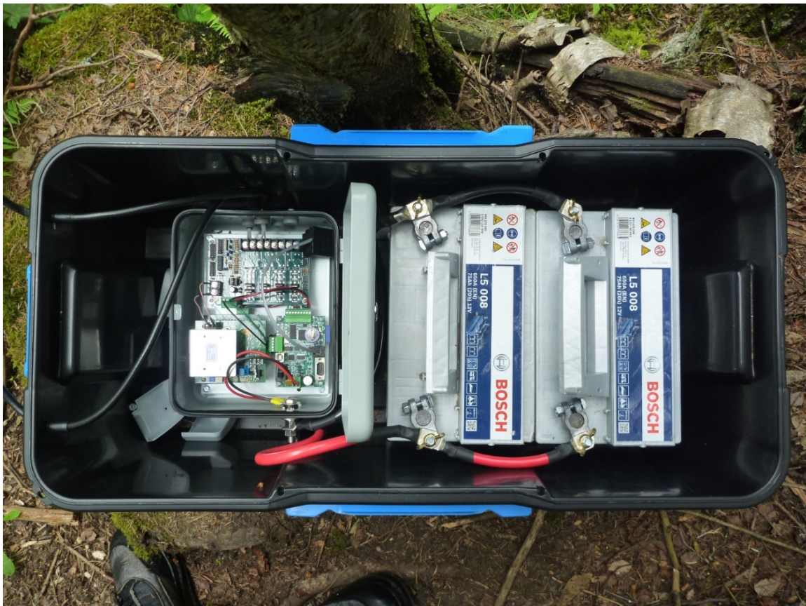
Vattentät box med batterier och läsare
