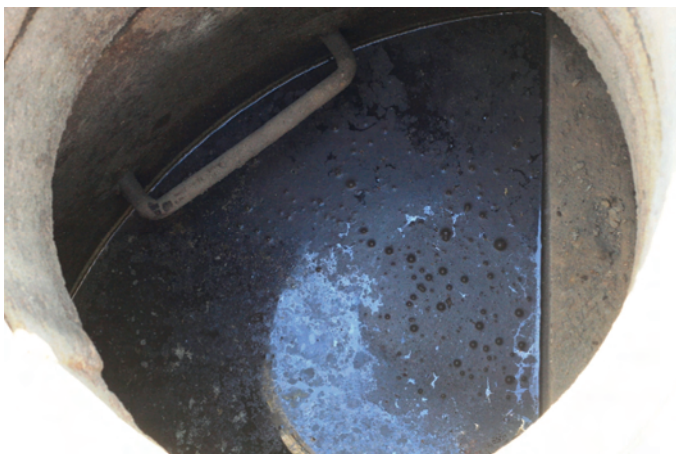
Bild 4. Dagvattenbrunn vid oljedepåområdet
