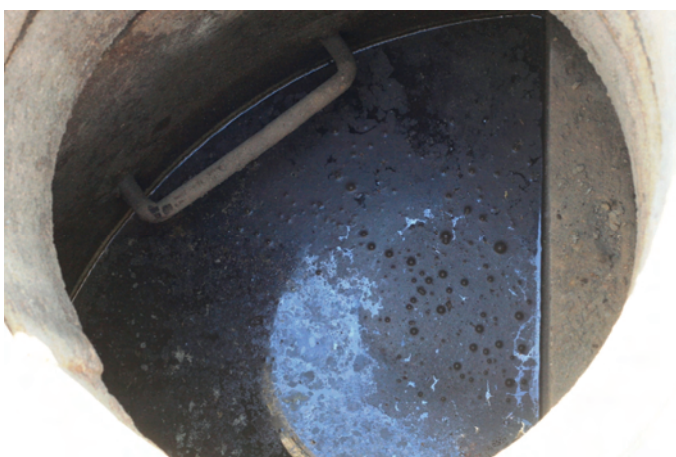
Bild 4. Dagvattenbrunn vid oljedepåområdet
