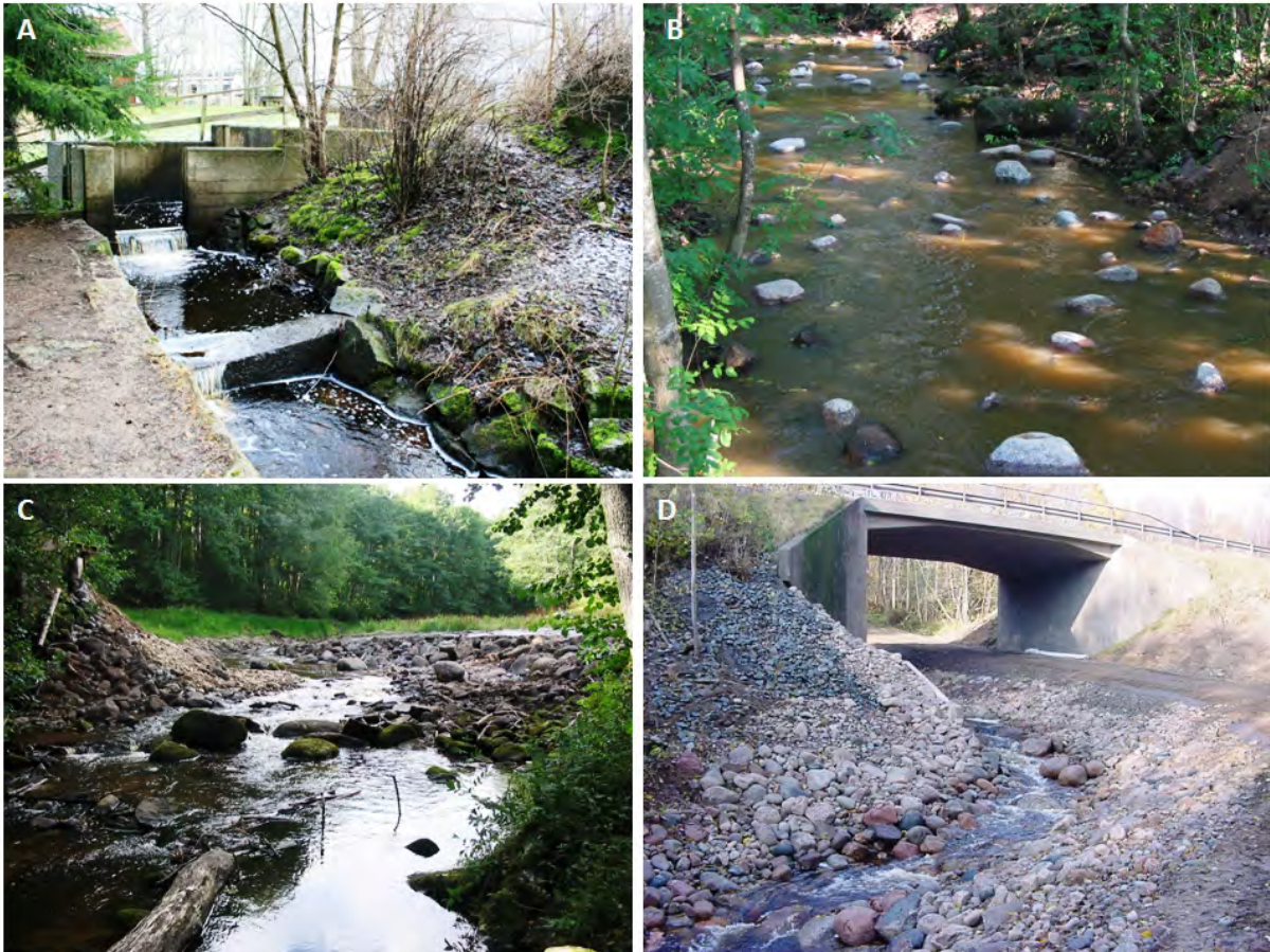
Figur 14. Exempel på genomförda fiskevårdsåtgärder i Vätterns tillflöden. Bassängtrappa i Tabergsån (A), Biotopvård i Hökesån (B), utrivning av Laggaredammen i Hökesån (C) och omlöp under väg 195 i Skänningsforsån (D). Foto: Länsstyrelsen i Jönköpings läns arkiv och Per Sjöstrand, Jönköpings Fiskeribiologi.
