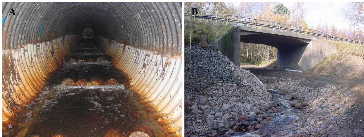
Figur 24. Svårpasserbar vägtrumma under väg 195 i Skämningsforsån (A) där ett omlöp nu har anlagts runt trumman (B) (arkivfoto Länsstyrelsen i Jönköpings län).
