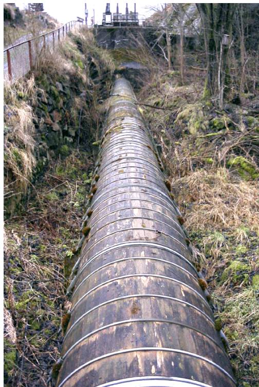
Figur 3. Allt som återstår av Edeskvarnaån (förr Hanaån) är en trätub ned till Vättern. Här fanns förr både öring och ål samt kvarnverksamhet från minst 1300-talet (Malmvall 1976). Ålfisket omtalas i dokument från 1760 (Edstrand 1976). År 1919 byggdes kraftverket och allt vatten leddes in i trätuben. En å har tystnat.
