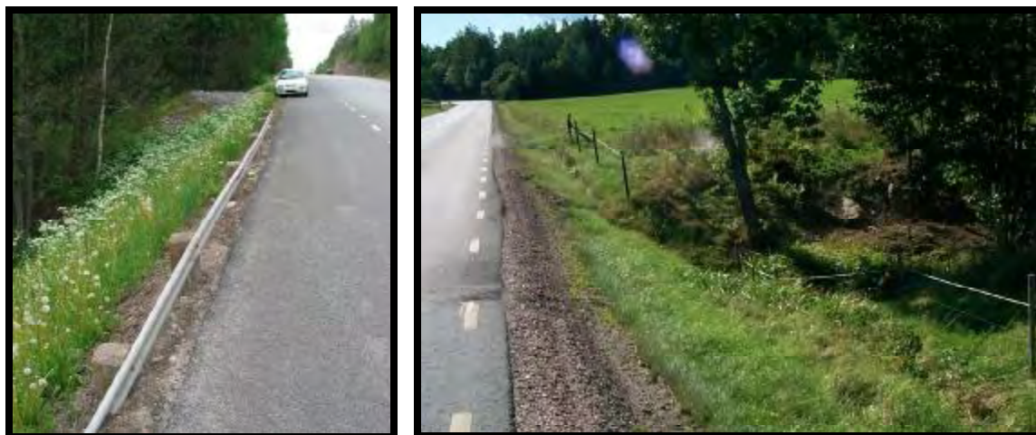
Figur 10. Exempel där antingen räcket är för klen, (Hultsjöån) eller där räcke saknas, (Åviksbäcken).
